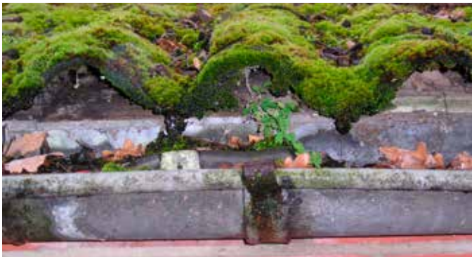
Asbest unter Moos: In Wellplattendächern kommt der gefährliche Stoff häufig vor. Foto: Bredehorn.J / pixelio.de
